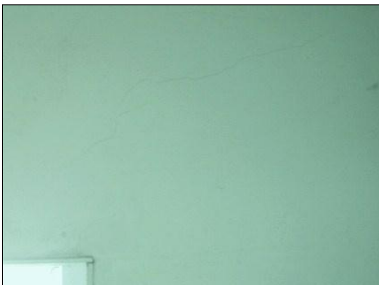
Figura 5: Fissura inclinada devido à verga inexistente ou falha
