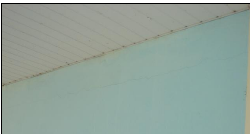
Figura 6: Fissura horizontal devido à movimentação térmica da laje de cobertura
