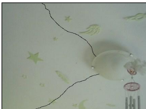
Figura 7: Fissura devido pequena espessura de cobertura dos conduítes na laje
