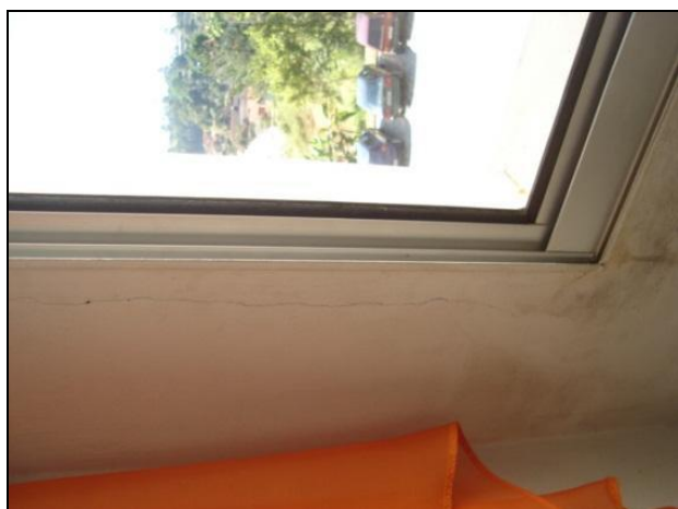
Figura 4: Fissura horizontal devido à movimentação higroscópica da alvenaria
