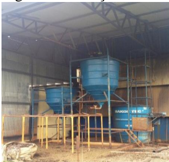
Figura 6 – Estação de tratamento.
