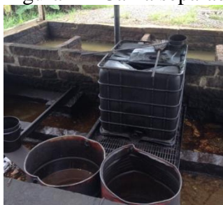
Figura 4 – Caixa separadora de água/óleo.
