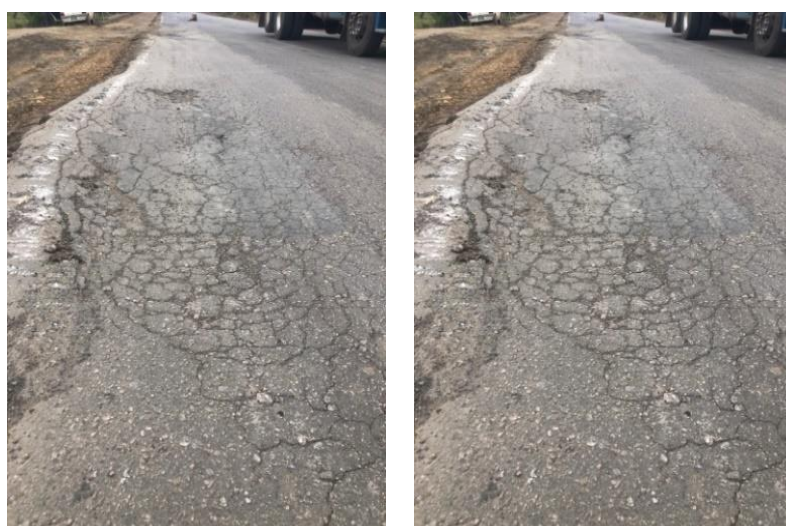
Figura 2. Afundamento plástico, escorregamento e trincas em trilha de roda externa.
