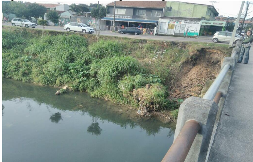
Figura 11 – Área com erosão próximo à ponte sobre o rio Belém
